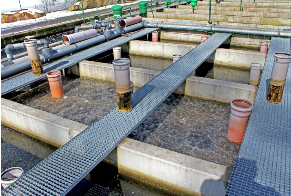
Obr. 5: ponořená část biofitru při čistění
