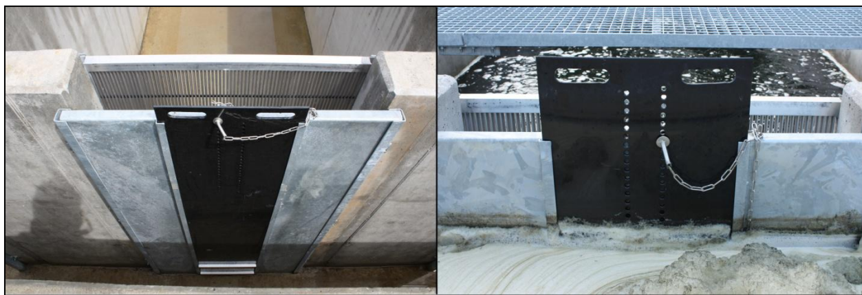
Obr. 8: Detail přítokové části odchovných žlabů recirkulačního systému rybí farmy v Pravíkově s regulačním mechanismem v podobě šoupěte. Na obrázku vpravo je šoupě nastaveno na 7. Otvor
